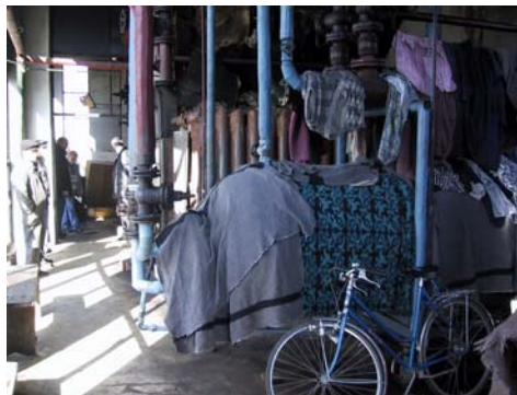
Bestaand ketelhuis in Poinele
