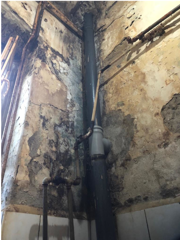
Schade in de ondergelegen sanitaire ruimte
