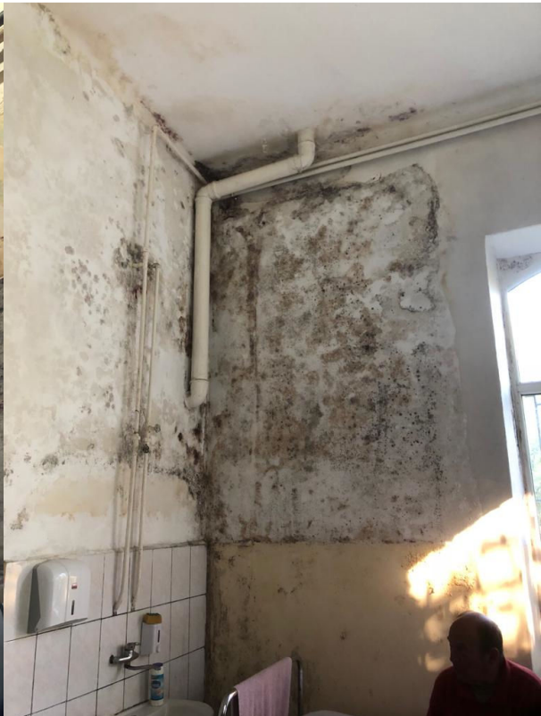
Schade in de naastgelegen slaapzaal (7 bedden)
